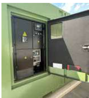
Übersichtliches Bedienfeld hinter versperrbarer Tür mit Sichtfenster
